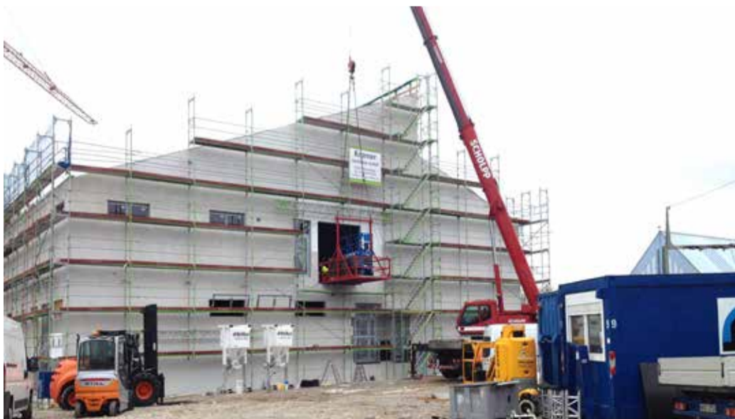
Unter Spannung: Im Inneren des Umspannwerks wird das Stromnetz auf 110.000 Volt umgerüstet.
